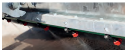
Szórószerkezet- a házhoz rögzített fúvókák vizet permeteznek, ezáltal megakadályozzák a por keletkezését
